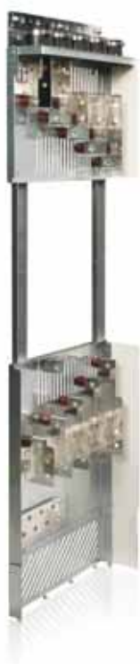
Дополнительная панель разводки кабелей +H381
