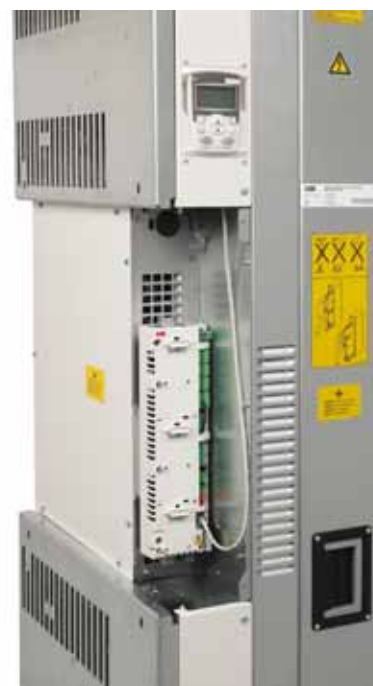
Дополнительный (встроенный) блок управления +P905 с панелью управления (+J400)
